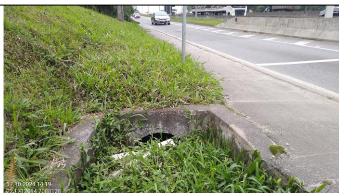
Figura 57: Dispositivo da drenagem pluvial da marginal. Fonte: Autor, 2024
