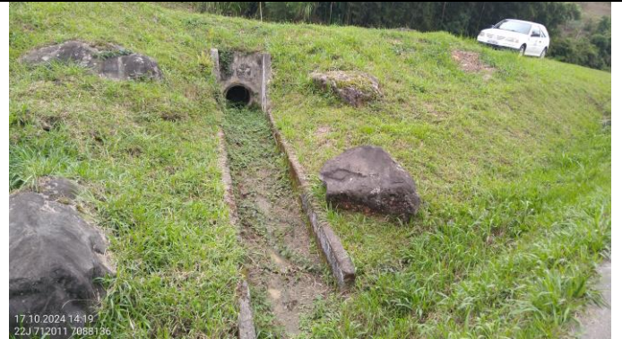
Figura 47: Trecho 23 – B galeria pluvial. Fonte: Autor, 2024.
