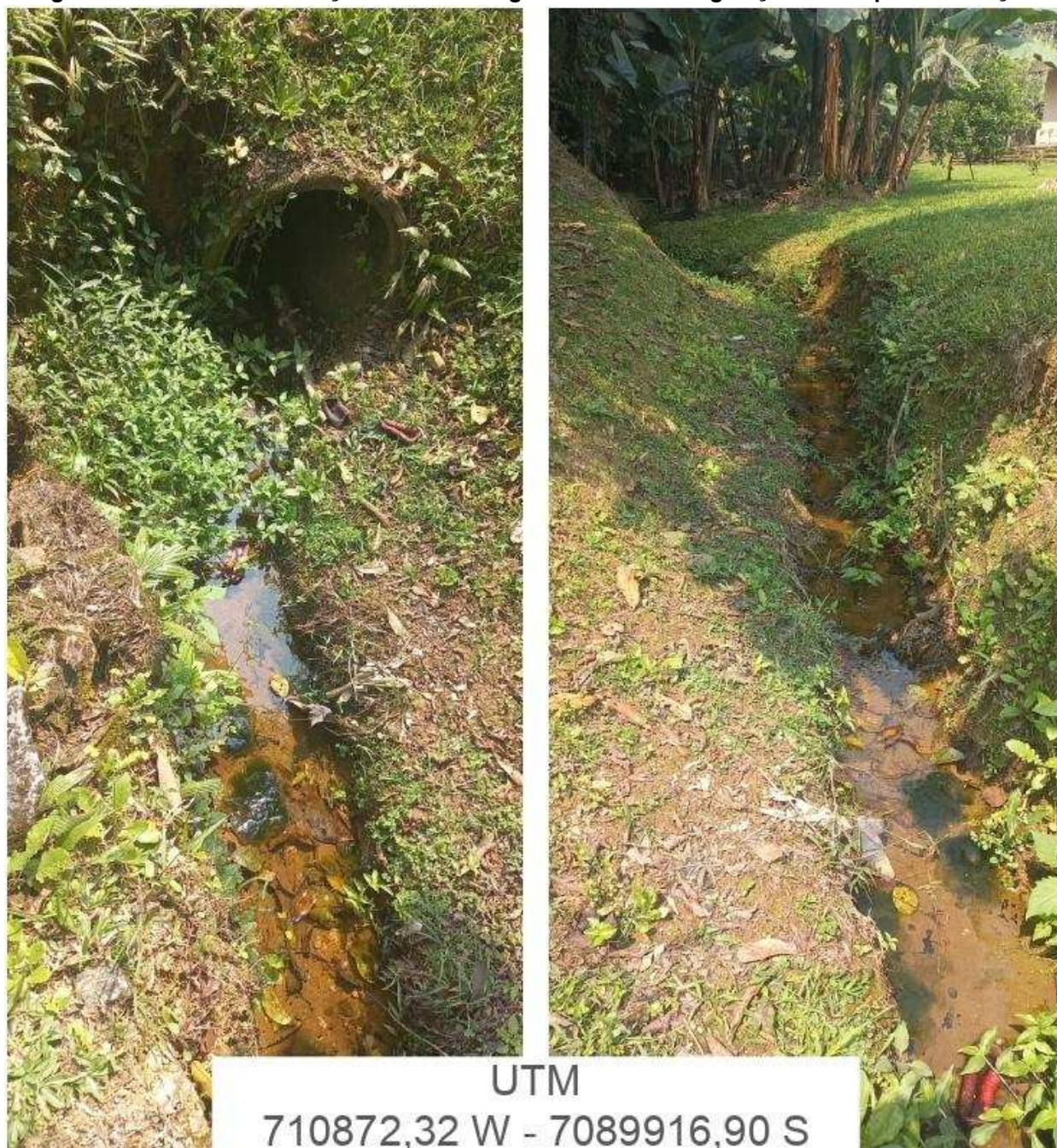
Figura 25: trecho 23 - transição de curso d'água aberto com vegetação densa para tubulação
