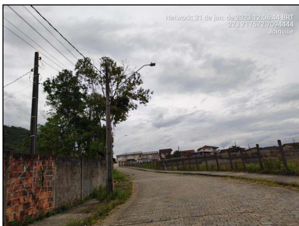
Figura 11: Distribuição de energia elétrica. Fonte: Autor, 2023.
