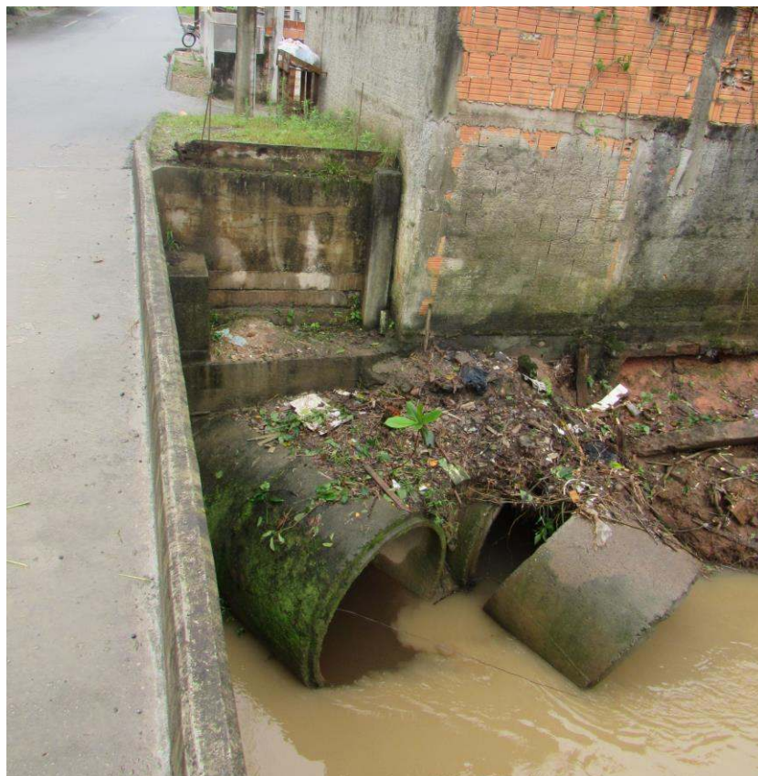
Figura 57: Saída do trecho 24 (tubulado) no rio Águas Vermelhas.
