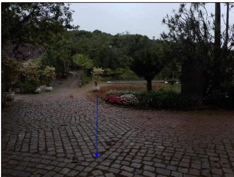
Foto 120 - Trecho 120a (P34), tubulado a jusante do reservatório/represamento. Nota: necessita de correção da base.
