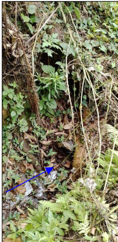
Foto 66 - Trecho 20, ingresso do corpo d'água aberto em tubulação (P17).
