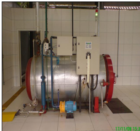
Figura 110 - Autoclave para tratamento dos resíduos do serviço de saúde Fonte – Arquivo pessoal – Fábio Elling Schaden
