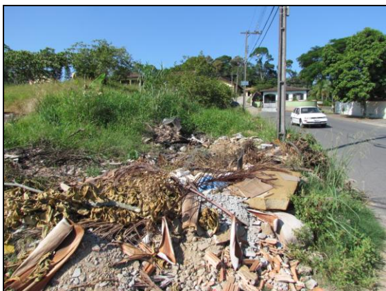
Figura 122 - Disposição inadequada de resíduos da construção civil
