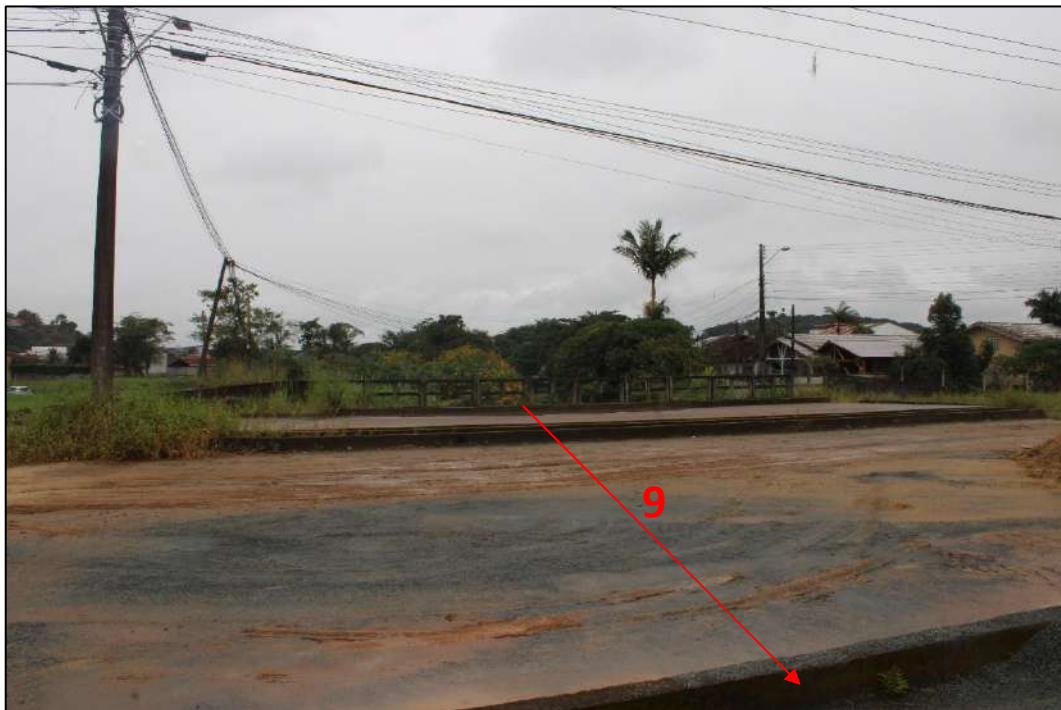
Figura 64: Indicação do trecho 9 (Corpo d'água Tubulado/galeria fechada/via), localizado no Quadrante B . Em vermelho, indicação do sentido do fluxo d'água e nº do trecho. Fonte: vistoria realizada no dia 30/05/2023 pela equipe técnica da Bioeco.
