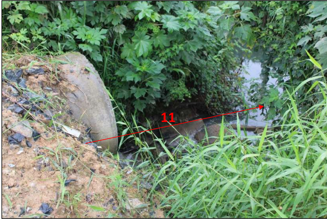
Figura 65: Indicação do trecho 11 (Corpo d'água Tubulado/galeria fechada/via), que desemboca no trecho 10, localizado no Quadrante B . Em vermelho, indicação do sentido do fluxo d'água e nº do trecho. Fonte: vistoria realizada no dia 30/05/2023 pela equipe técnica da Bioeco.
