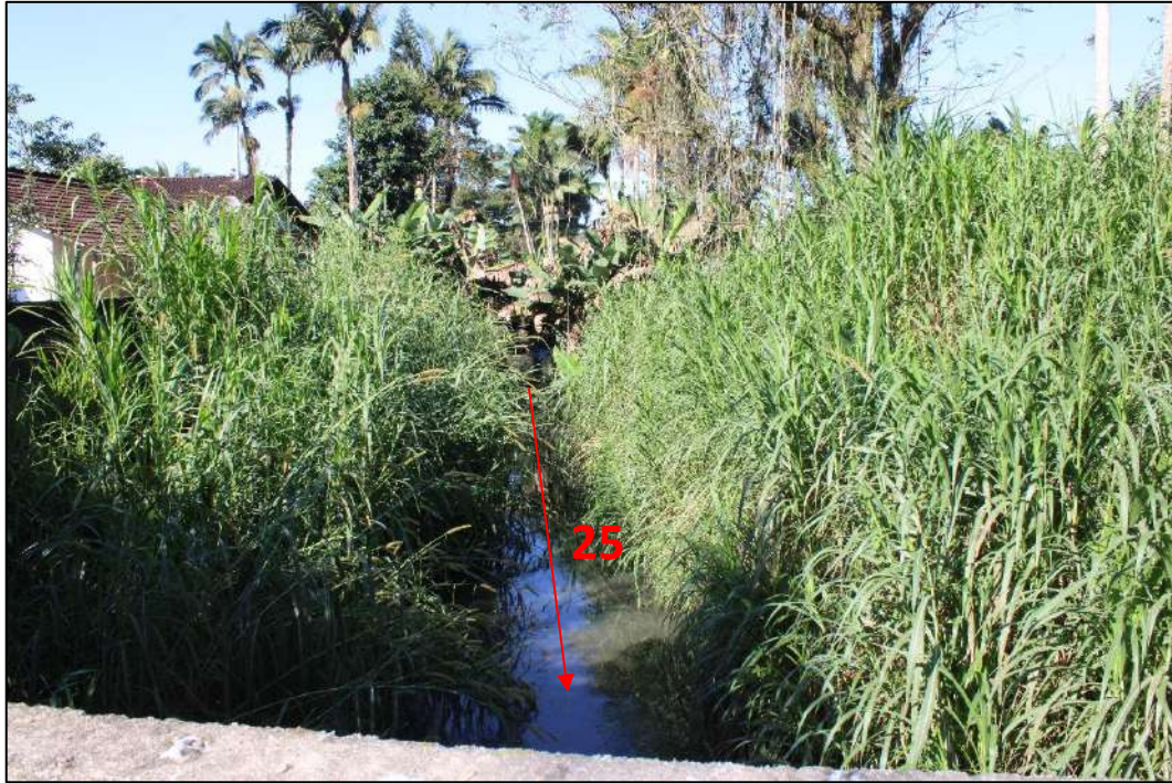
Figura 87: Vista para Montante do trecho 25 (Corpo d'água aberto com vegetação isolada em meio antrópico), localizado no Quadrante G . Em vermelho, indicação do sentido do fluxo d'água e nº do trecho. Fonte: vistoria realizada no dia 01/06/2023 pela equipe técnica da Bioeco.
