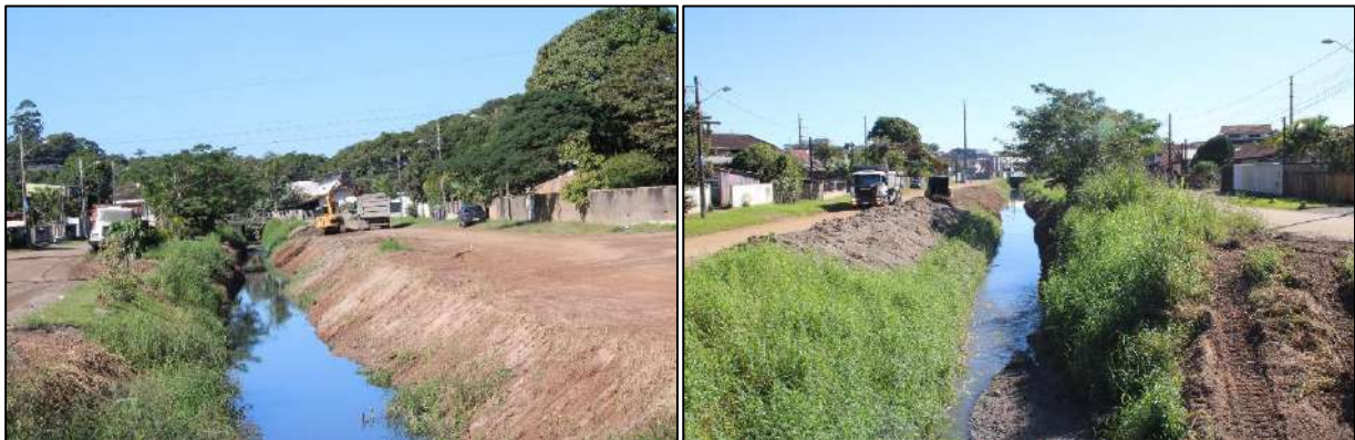
Figura 24: Caracterização do Trecho 33 , onde o corpo d'Água aberto encontra-se com o solo parcialmente exposto e com a presença da comunidade herbácea. Fonte: vistoria realizada no dia 01/06/2023 pela equipe técnica da Bioeco.
