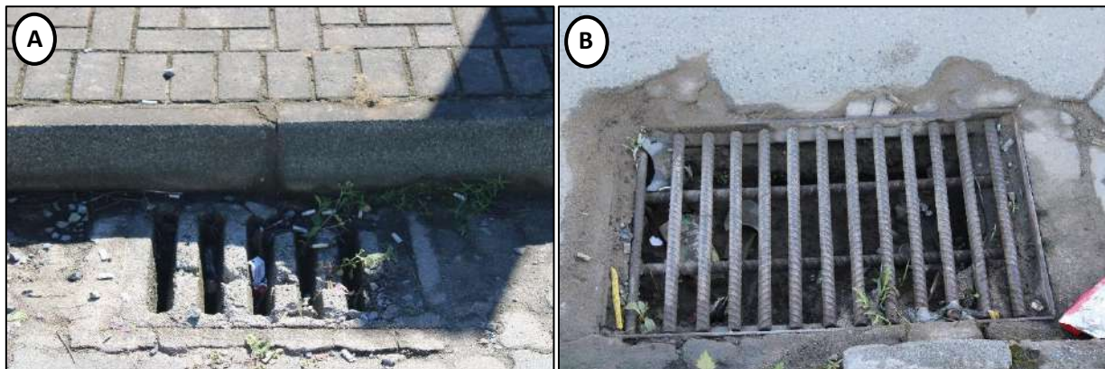
Figura 39: Bocas de lobo tipo grelha. Legenda: A – Rua Constantino Caetano; B – Rua João Bertoli. Fonte: vistoria realizada no dia 01/06/2023 pela equipe técnica da Bioeco.
