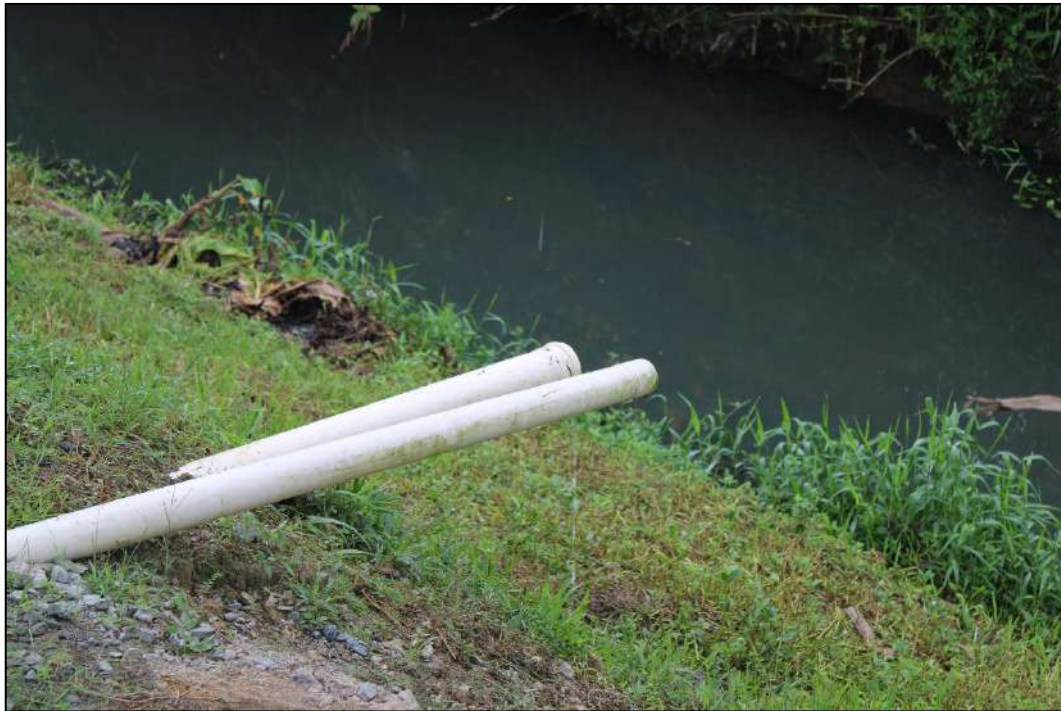
Figura 67: Despejo de efluente doméstico em corpo d'água (Trecho 10). Fonte: vistoria realizada no dia 30/05/2023 pela equipe técnica da Bioeco.
