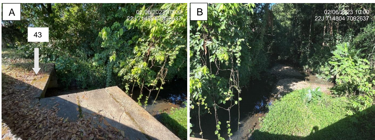
Figura 33: A: Trecho 43 (tubulado) para trecho 44A, aberto. B: Trecho 43, vista para jusante. Fonte: Autores.
