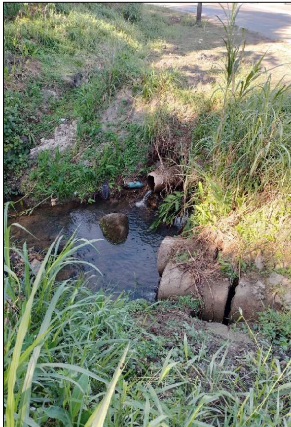
Foto 26 - Desemboque do corpo d'água principal fechado sob a Rua Dona Francisca em trecho aberto em calha retificada (início do trecho aberto 21 – P6).
