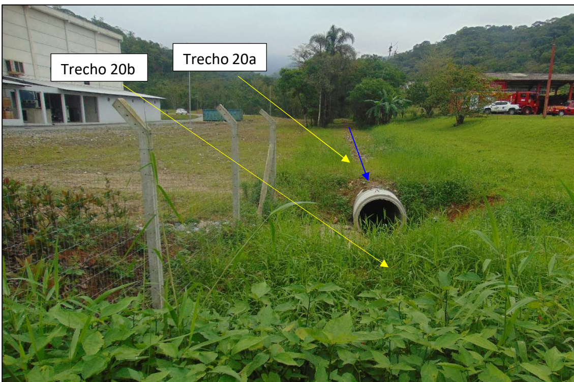
Foto 24 - Vista para os trechos 20a (fechado) e 20b (aberto), pouco antes do ingresso em tubulação sob a Rua Dona Francisca (P5). Nota: Trecho 20a necessita de correção da base.
