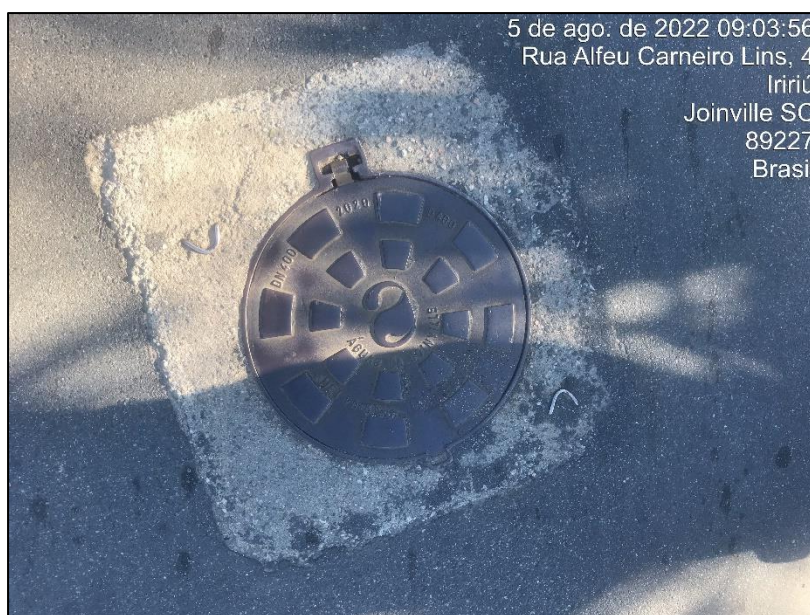
Foto 20 - Caixa de inspeção da Cia. Águas de Joinville no Trecho 5 (fechado sob a Rua Alfeu Carneiro Lins).
