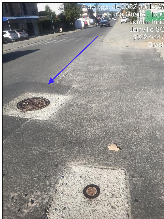
Foto 22 - Trecho 7 fechado sob a Rua Guaíra. Nota: presença de caixa de inspeção da Cia. Águas de Joinville.
