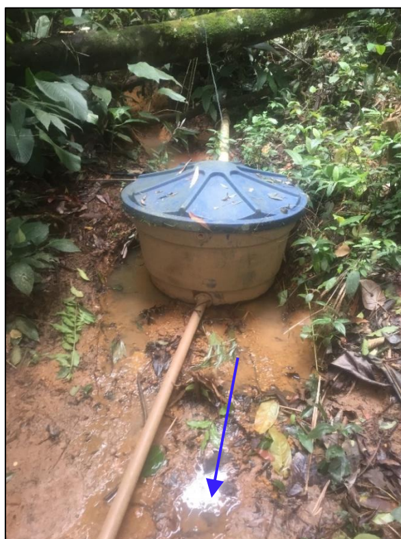
Foto 14 - Trecho 1, aberto em área de vegetação densa. Nota: caixa d'água instalada por moradores das proximidades, para captação de água para abastecimento residencial local.
