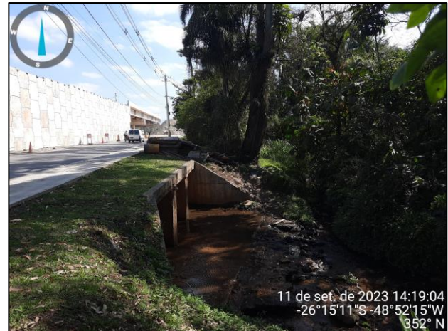
Figura 42 – (R21) Vista para o trecho 60 com destaque para a saída da galeria fechada (Fonte: Carbono Engenharia, 2023).
