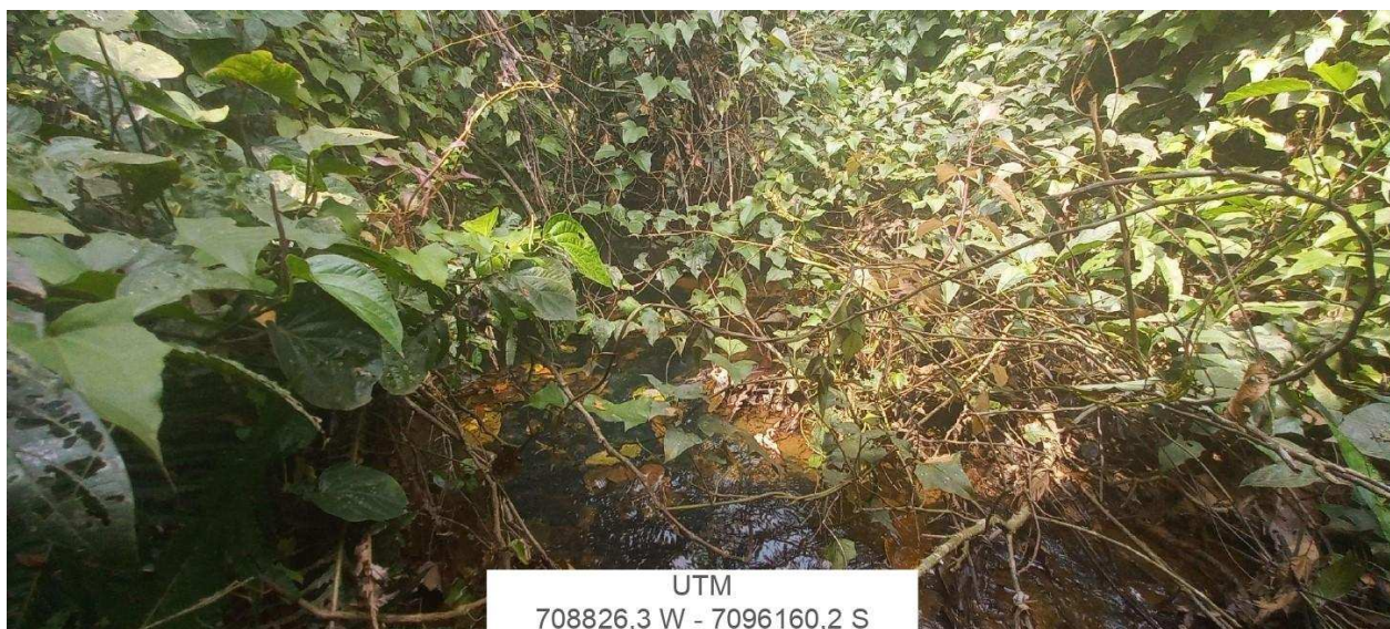
Figura 27: trecho 79 - transição de curso d'água aberto com vegetação densa para tubulação
