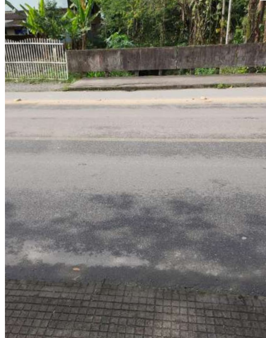
Figura 31: Trecho 02, demonstrando corpo d'água fechado sob via.
