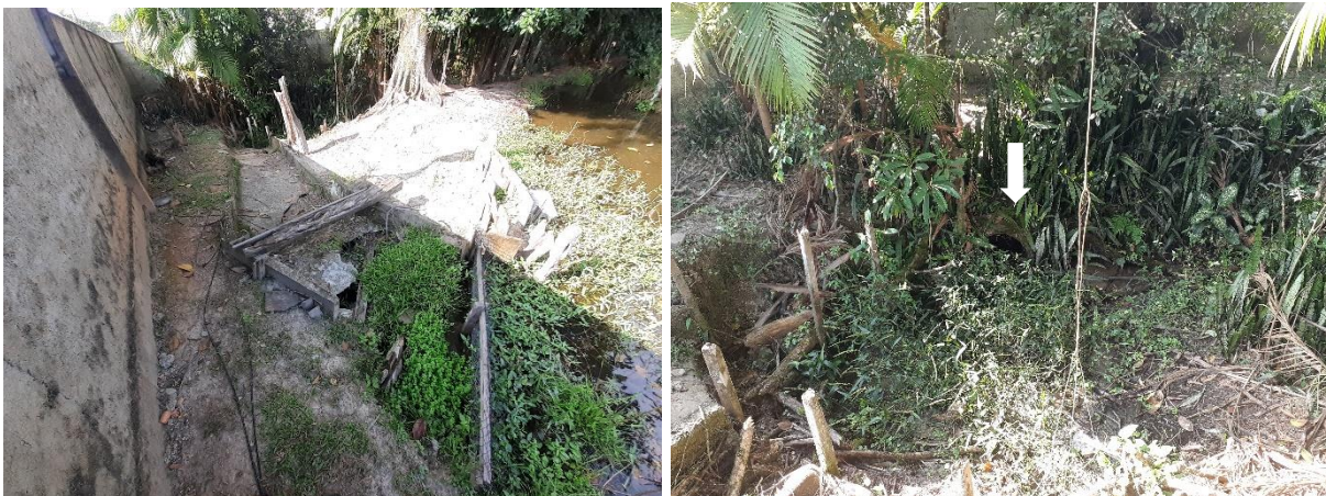
Figura 32: Tubulação de saída do represamento 15B (esq.) tubulação para rua (dir.) Fonte: Autores.
