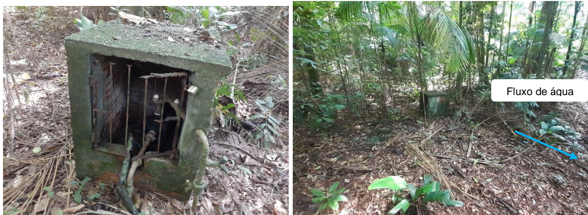
Figura 24: Poço de captação de água subterrânea na proximidade do ponto onde está definida a nascente do trecho 13A pelo levantamento municipal. Fonte: Autores.
