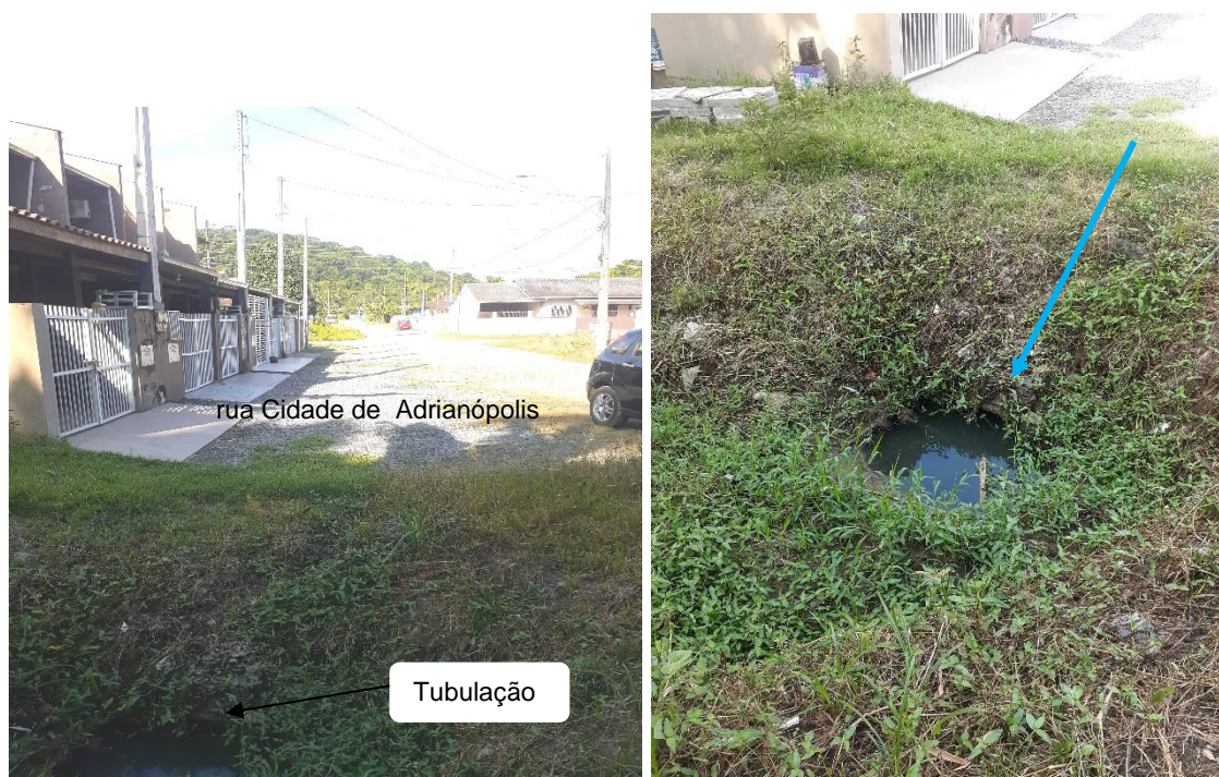
Figura 33: Tubulação que inicia o trecho 17A. Fonte: Autores.
