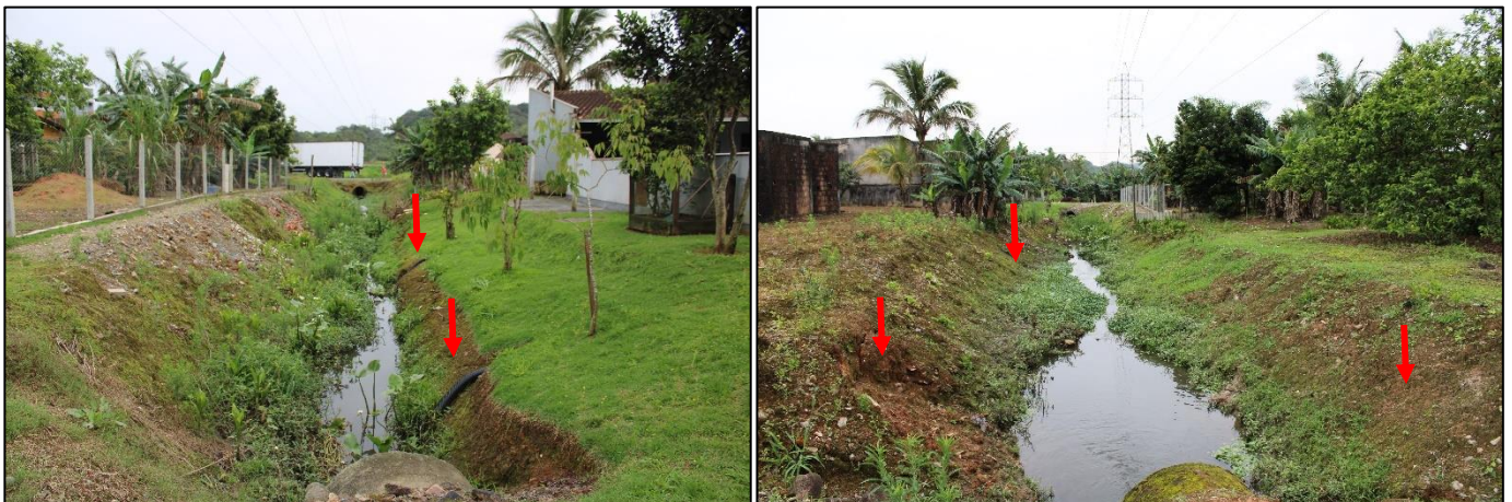
Figura 3: Área com risco geológico-geotécnico na margem do corpo d'água referente ao trecho 10. Fonte: Vistoria realizada no dia 31/10/2022 pela equipe técnica da Bioeco.
