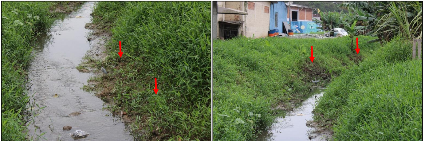
Figura 2: Área com risco geológico-geotécnico na margem do corpo d'água referente ao trecho 8. Fonte: Vistoria realizada no dia 31/10/2022 pela equipe técnica da Bioeco.
