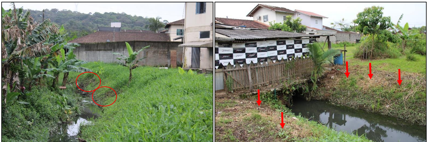
Figura 1: Área com risco geológico-geotécnico na margem do corpo d'água referente ao trecho 6. Fonte: Vistoria realizada no dia 31/10/2022 pela equipe técnica da Bioeco.
