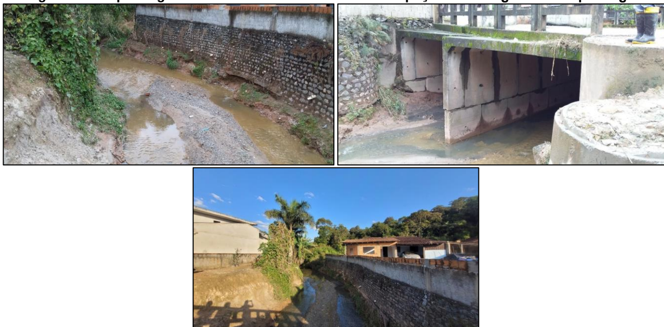
Figura 34 - Aspecto geral do trecho 48 evidenciando a ocupação nas margens do corpo d'água.
