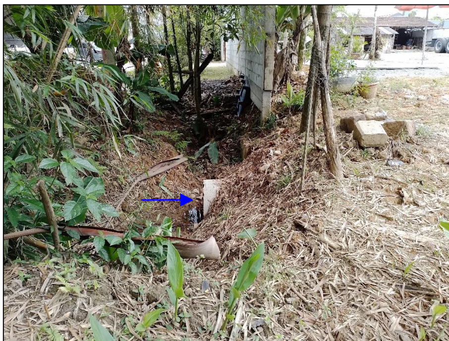
Foto 57 - Ingresso de fluxo hídrico da nascente em tubulação (Trecho 15a – P14). Nota1: a nascente encontra-se a poucos metros da tubulação; Nota2: necessita de correção da base.
