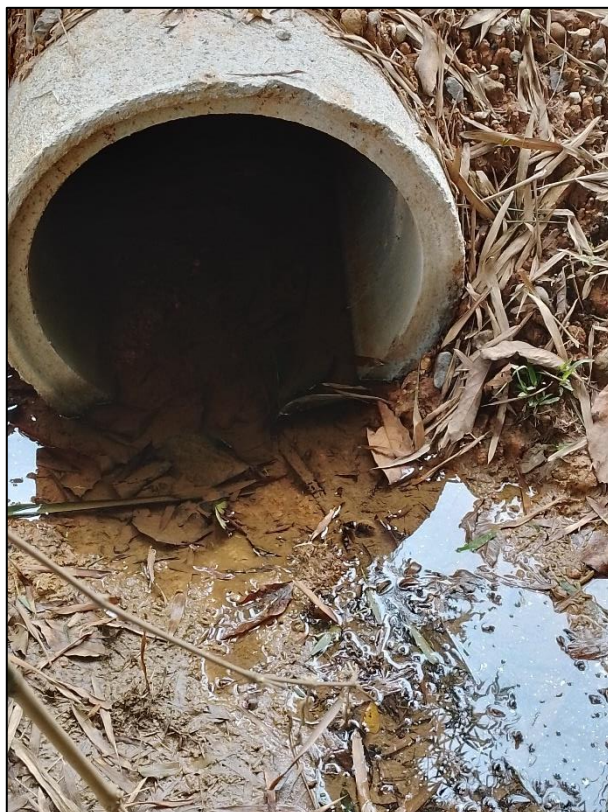
Foto 56 - Ingresso de fluxo hídrico da nascente em tubulação (Trecho 15a – P14). Nota1: a nascente encontra-se a poucos metros da tubulação; Nota2: necessita de correção da base.
