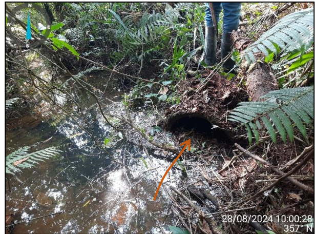
Figura 35 – (R24) Vista para a entrada da tubulação fechada sob via do trecho 39 com destaque para a presença de vegetação (Fonte: Carbono Engenharia, 2024).
