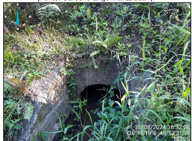
Figura 17 - (R8) Vista para a saída da tubulação do trecho 19, com presença de vegetação no entorno. (Fonte: Carbono Engenharia, 2024).
