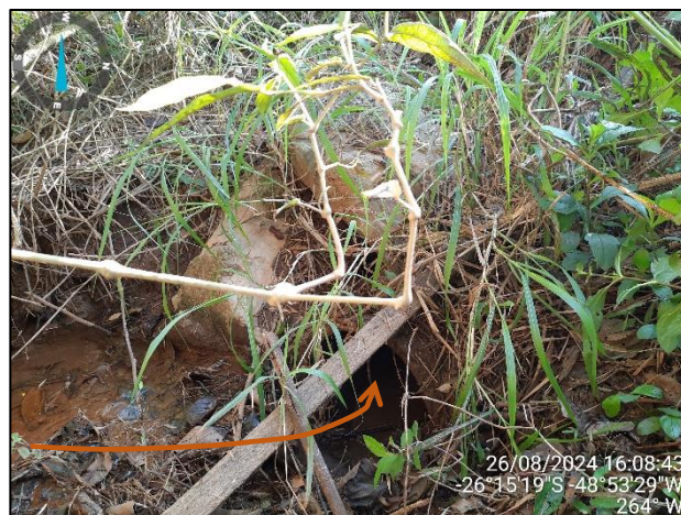
Figura 24: (R14) Vista para a entrada da tubulação no trecho 32 com destaque para a presença de vegetação no entorno (Fonte: Carbono Engenharia, 2024).
