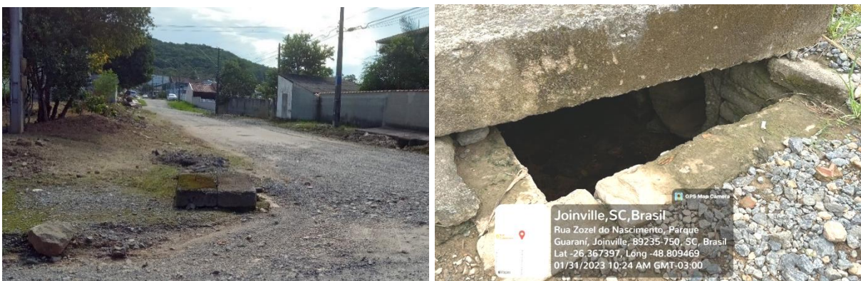
Figura 16: Rua Zozel do Nascimento, trecho 11 para trecho 12. Rua sem pavimentação, com bocas de lobo. Fonte: Autores.
