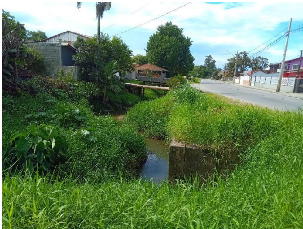
Figura 73: Início do trecho 51, aberto, visto a partir do trecho 50, fechado sob via. Fonte: Autores.
