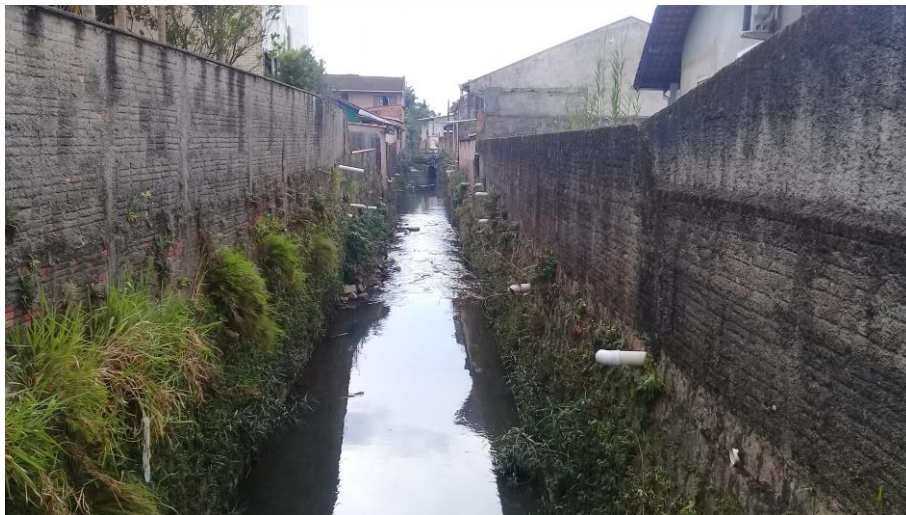
Figura 54: Trecho 69, a partir da rua Elly Soares (trecho 68). Observam-se diversas tubulações de lançamento de águas servidas e/ou drenagem. Fonte: Autores.
