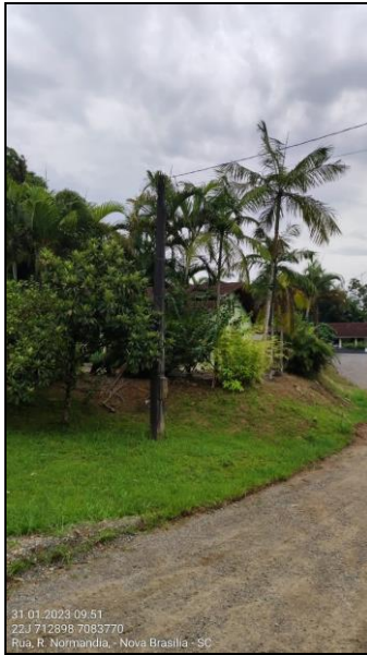
Figura 25: Rede de distribuição de energia elétrica. Fonte: Autor, 2023.
