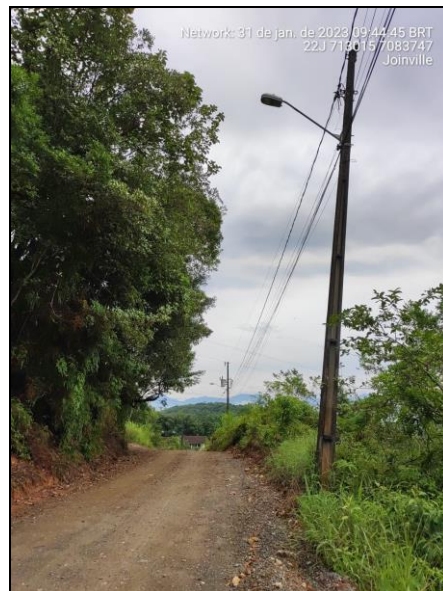
Figura 24: Rede de distribuição de energia elétrica. Fonte: Autor, 2023.
