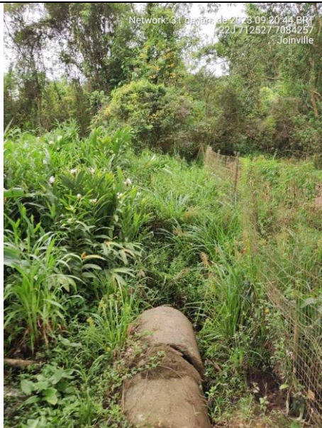
Figura 34: Limite entre trechos 16 (tubulado) e 17 (aberto) Fonte: Autor, 2023
