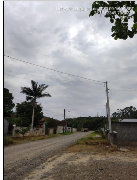
Figura 26: Rede de distribuição de energia elétrica. Fonte: Autor, 2023.
