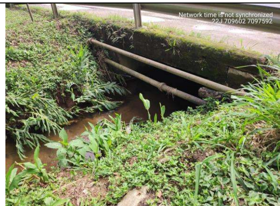
Figura 12: Trecho 30, entrada para trecho 31 tubulado sob via pública - Rua Dona Francisca.
