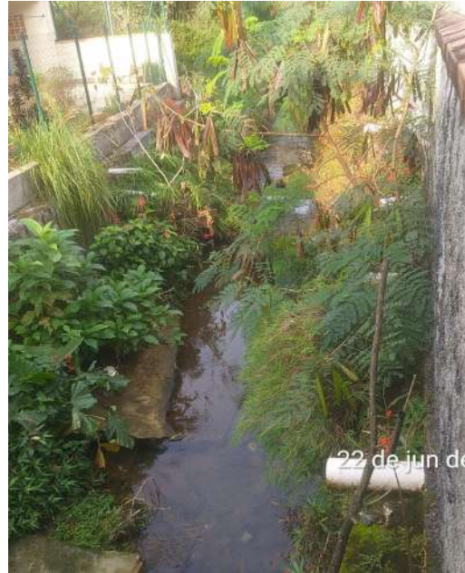
Figura 31: Trecho 57, sentido sul, no detalhe vista do trecho aberto com vegetação isolada.
