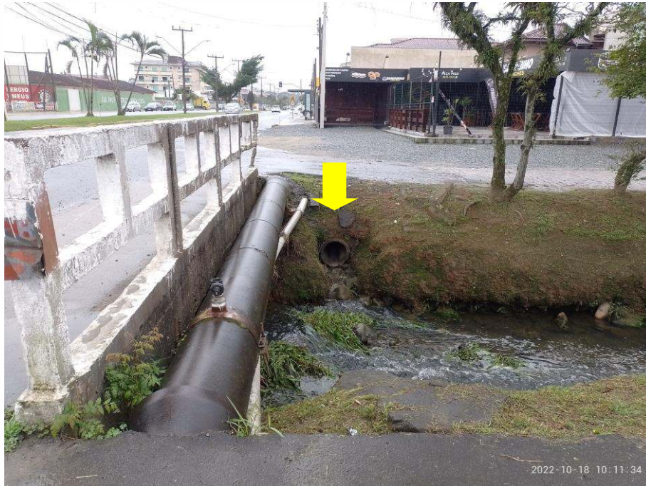
Figura 20: Contribuição de drenagem no rio Célio Gomes, trecho 50, rua dos Radialistas. Fonte: Autores.
