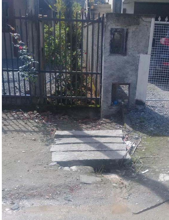
Figura 23: Detalhe de possível tubulação do trecho 5, rua Samuel Figueiredo. Fonte: Autores.
