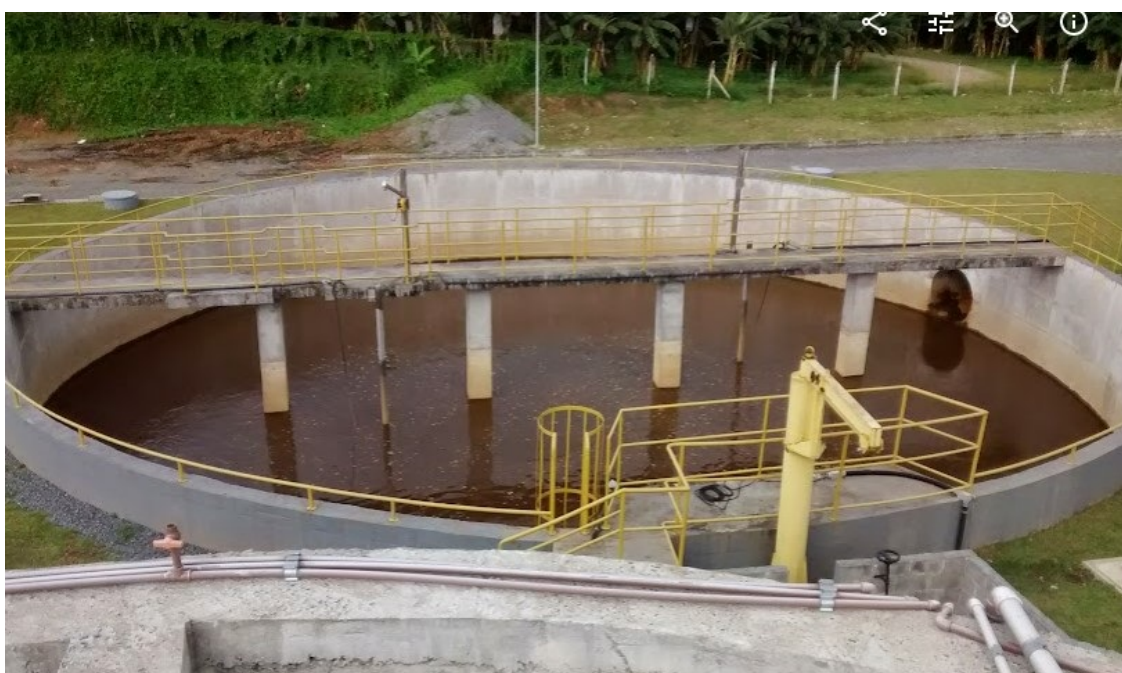
Figura 2 - Tanque de Equalização da ETL - Rejeito ETA Cubatão
