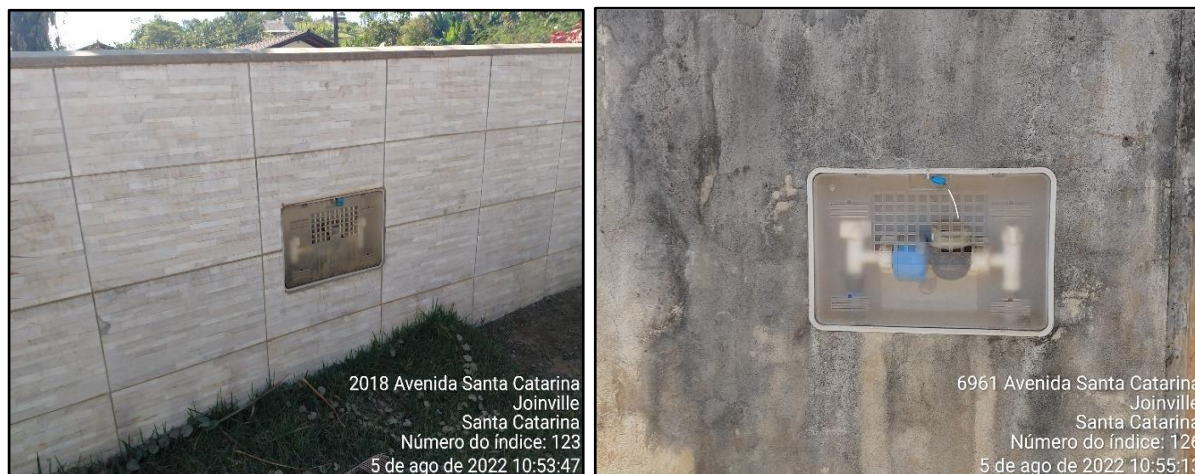
Figura 9: Medidores de consumo de água. Fonte: vistoria realizada no dia 05/08/2022 pela equipe técnica da Bioeco.
