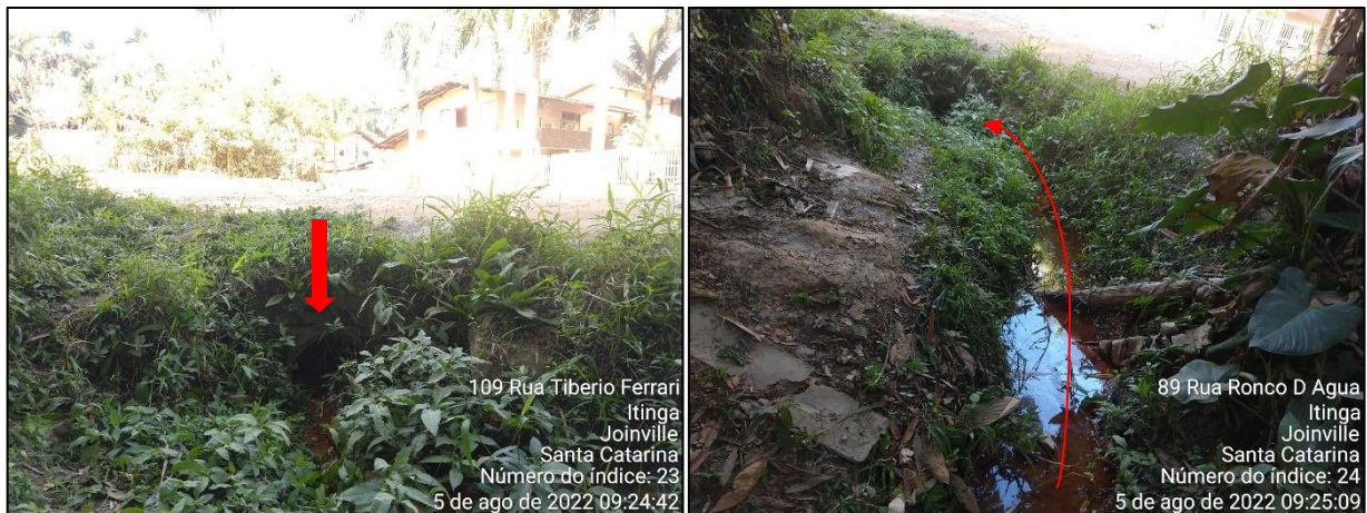
Figura 13: Tubulação de ligação de curso d'água aberto à rede de drenagem. Fonte: vistoria realizada no dia 05/08/2022 pela equipe técnica da Bioeco.
