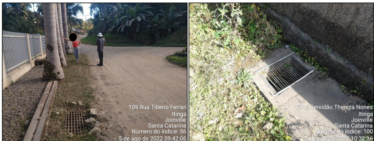
Figura 11: Bocas de lobo tipo grelha. Fonte: vistoria realizada no dia 05/08/2022 pela equipe técnica da Bioeco.
