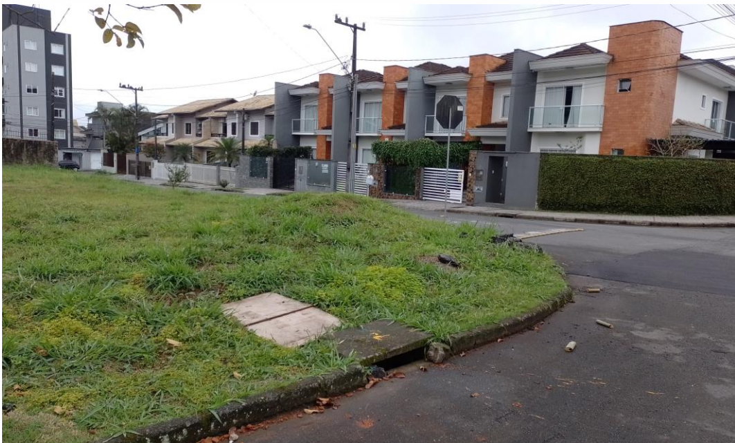
Figura 21: Rede de distribuição de energia elétrica e boca de lobo na rua João Koneski. Fonte: Autores.
