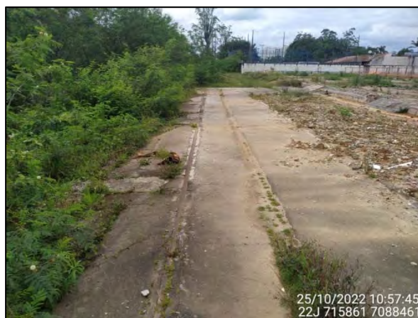
Figura 3.5.1.2.1: Vista parcial do resquício da ferrovia inativa no interior da Microbacia 13-10. Fonte: OAP (2022).
