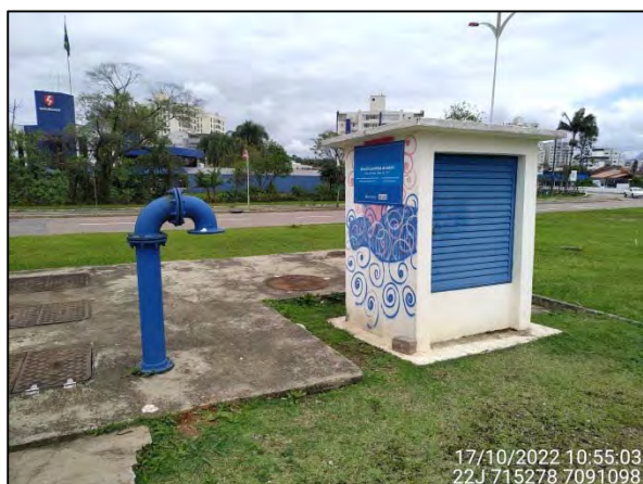
Figura 3.5.1.8.1: Estação Elevatória de Esgoto (Rua José Vieira). Fonte: OAP (2022).
