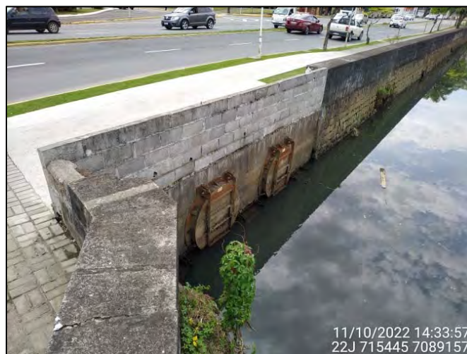
Figura 3.8.6.8: Vista parcial do término do Trecho 30 no Quadrante F – Foz do rio Mathias. Fonte: OAP (2022).
