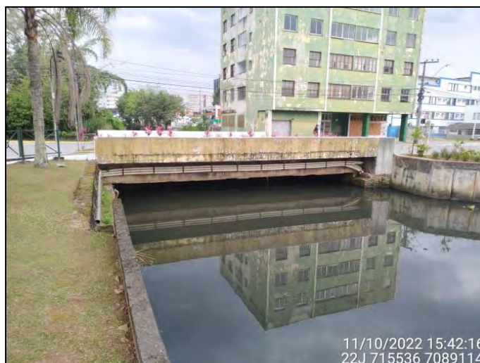
Figura 3.8.6.12: Vista parcial do término do Trecho 31 e início do Trecho 32 no Quadrante F - Jusante. Fonte: OAP (2022).
