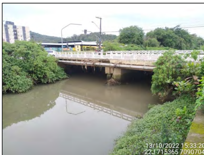
Figura 3.8.3.17: Vista parcial do término do Trecho 14 e início do Trecho 15 no Quadrante C – Jusante. Fonte: OAP (2022).
