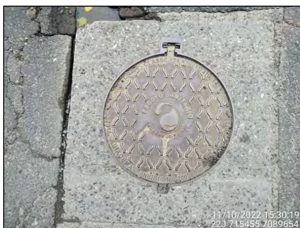
Figura 3.5.1.8.3: Caixa de inspeção de esgoto (Avenida Hermann August Lepper). Fonte: OAP (2022).
