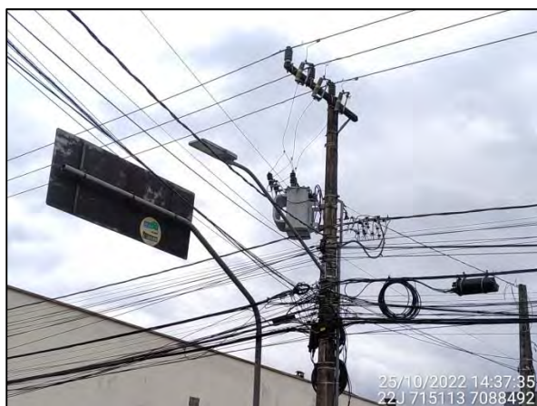
Figura 3.5.1.9.1: Elementos de distribuição de energia elétrica e iluminação (Rua Ministro Calógeras). Fonte: OAP (2022).
