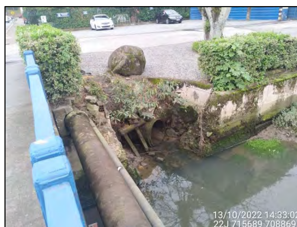
Figura 3.5.1.5.6: Sistema de drenagem integrado ao rio Cachoeira (Rua Carlos Frederico Adolfo Schneider). Fonte: OAP (2022).
