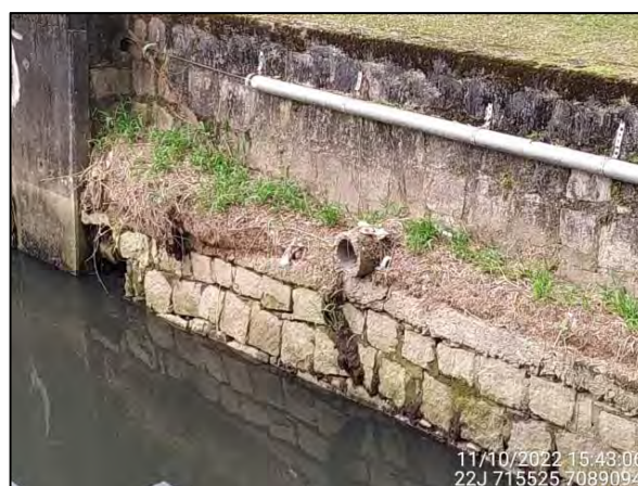
Figura 3.5.1.5.4: Sistema de drenagem integrado ao rio Cachoeira (Avenida Hermann August Lepper). Fonte: OAP (2022).
