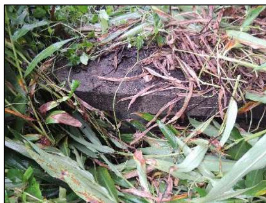
Foto 92: Quadrante A (trecho 02) – Dispositivo de drenagem – caixa de passagem.
