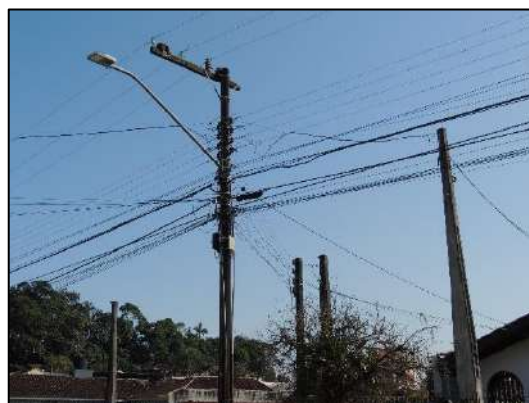
Foto 19: Elementos da distribuição de energia – posteamento, iluminação pública e fios de condução (Rua Tubarão).
