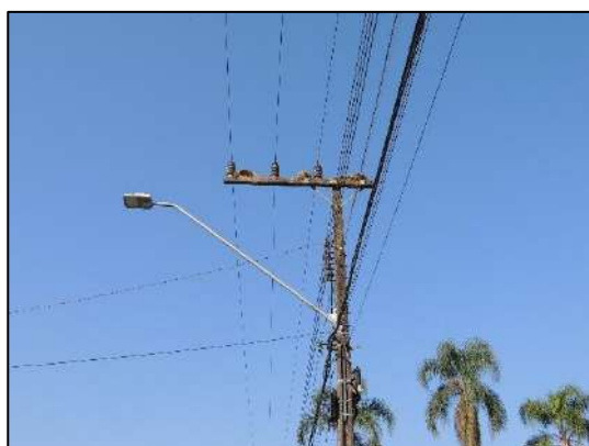
Foto 16: Elementos da distribuição de energia – posteamento, iluminação pública e fios de condução (Rua Orleans).
