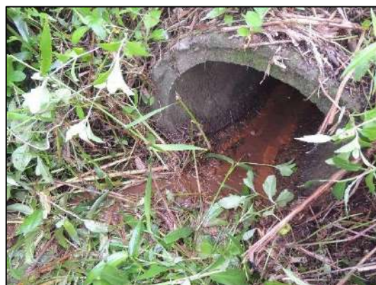
Foto 15: Quadrante B (trecho 03) - Tubulação do corpo hídrico quando da integração com o sistema de drenagem municipal.
