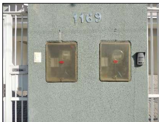
Foto 17: Equipamento de medição de consumo (Rua Visconde de Mauá).
