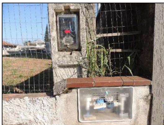
Foto 32: Medidor de água (Rua Fernando Machado).
