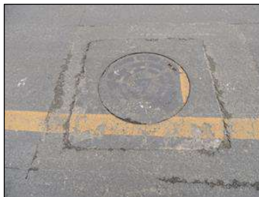
Foto 25: Detalhe do sistema de esgotamento – poço de visita na via (Rua Fernando Machado).
