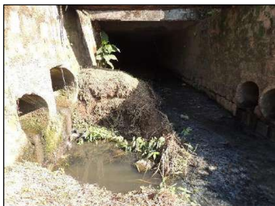
Foto 14: Quadrante D (trecho 08) - Drenagem incorporada ao corpo hídrico (Rua Machado de Assis esquina com Rua Almirante Barroso).
