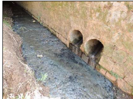
Foto 60: Trecho 8 – indícios de contaminação por esgoto doméstico, bem como contribuição da rede pluvial (01/08/2022).
