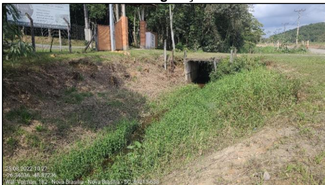
Figura 29 - Aspecto geral dos trechos 24A e 30, evidenciando a vegetação isolada.
