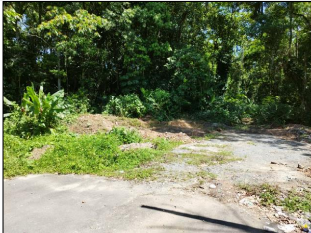
Figura 13: Vista para o trecho 32 com destaque para a ocorrência de trecho tubulado sob lotes (Fonte: Carbono Engenharia, 2023).
